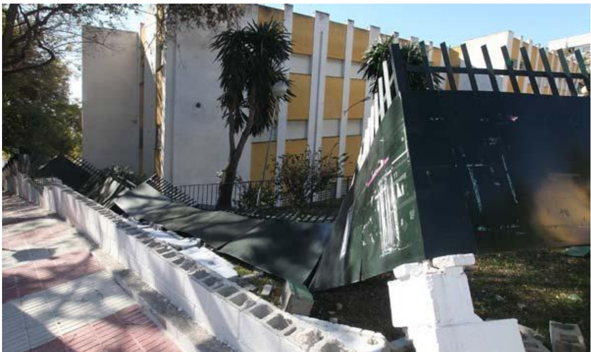
Figura 15. Efectos sobre un colegio en Marbella, causados por un episodio de vientos descendentes el 4 de febrero de 2012. Fuente: Europa Press
