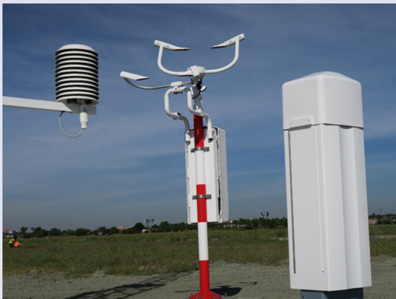
En la imagen, y de derecha a izquierda, ceilómetro, visibilímetro, tiempo presente y sensor de temperatura y punto de rocío, ubicados en la cabecera de la pista 05 de la base aérea de Getafe.
