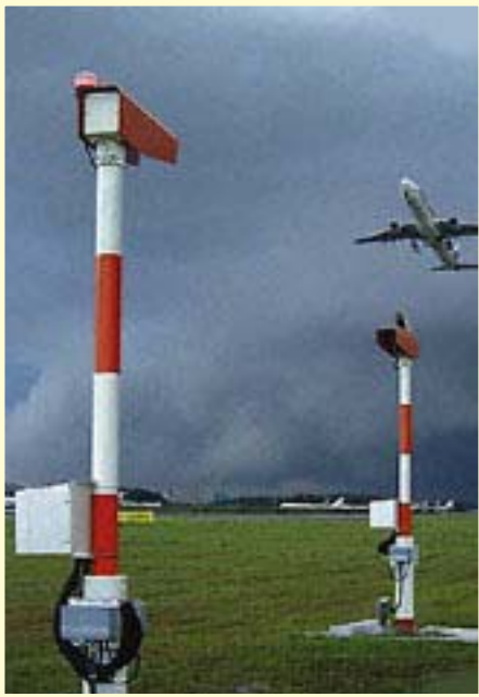
Medidor de RVR
